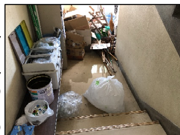
【南校舎1階の被害】
