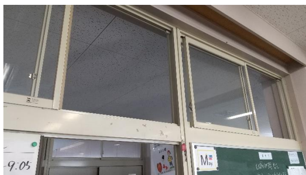
廊下側の窓は常に開放し、空気の流れをつくります。
